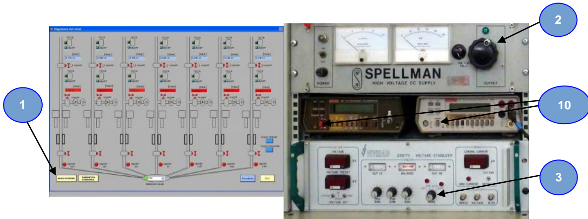
Fig. 2 b) : pannello del supervisore con il sinottico dei canali (e pulsante per attivare il BEAM STOPPER), foto del cassetto SPELLMAN, degli strumenti KEITHLEY e del cassetto di stabilizzazione.
