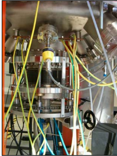
Figura 1-6 Soffietto in acciaio che permette il movimento in verticale degli elettrodi (nel caso specifico dell'anodo). In basso a destra si può notare la manopola per regolarne la posizione.
